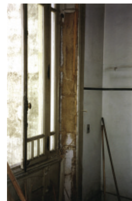
Foto 4: Detalhe do ataque dos cupins de solo nas arguições de pinho de riga nas janelas da biblioteca da FAU-Maranhão. Foto: Antonio Sarasá.
