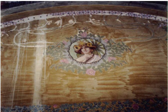
Figura 1: Estado de conservação das pinturas da parede da escadaria do Saguão principal do edifício em 1993, antes do restauro realizado pelo “Canteiro-Escola do CPC”. Foto: Roberto Bogo, 1993. Arquivo CPC-USP
