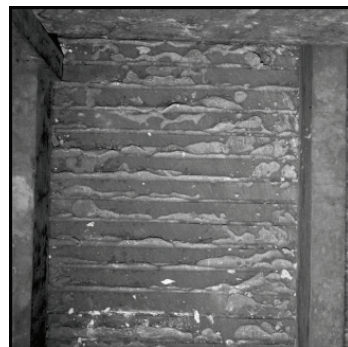
Foto 2: Vista de detalhe do forro de estuque e das patologias constatadas Foto: Osvaldo Gomes da Silva
