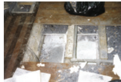
Foto 1: Estado do piso superior, suporte do material acústico e forro da biblioteca. Nota-se a tubulação de água colocada em reforma posterior da edificação. Biblioteca FAU-Maranhão. Foto: Antonio Sarasá.
