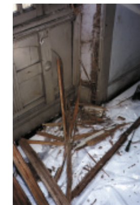
Foto 5: Estado da madeira devido ao ataque dos insetos xilófagos. Janelas da biblioteca da FAU-Maranhão. Foto: Antonio Sarasá.
