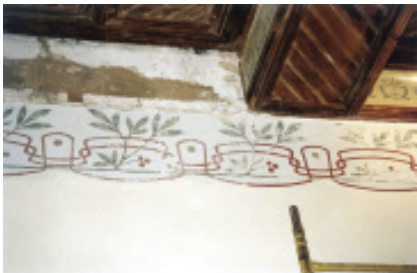
Foto 8: Frisos descobertos pela prospecção sobre a alvenaria das paredes e moldura de madeira atacada pelos insetos. Biblioteca FAU-Maranhão. Foto: Antonio Sarasá.
