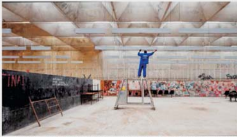
Funcionário instala luminárias no último piso interditado, que deve ser reaberto antes do início das aulas para seguir com os estudos.
